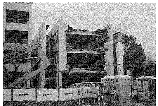
東館は崩壊し直ちに解体作業
