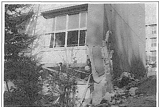
崩壊した校舎の側面 (提供：市立西宮高等学校)
